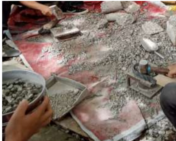
Gambar I. Limbah beton silinder
