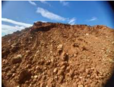
Gambar 3. Kondisi Longsor Pada Tumpukan Stockyard
