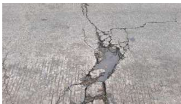
Gambar 3. Kerusakan pada Perkerasan Kaku
