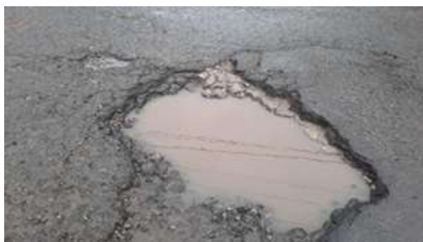
Gambar 2. Kerusakan pada Perkerasan Lentur
