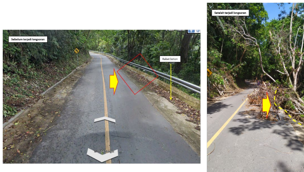
Gambar 1. Kondisi sebelum dan sesudah terjadi longsoran
